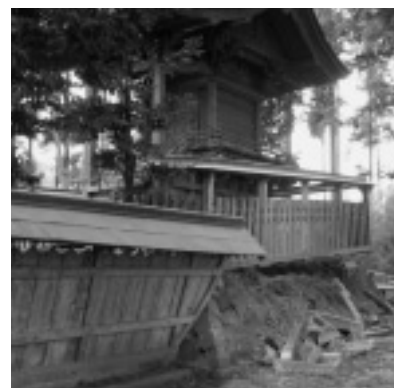
▲土台が被害を受けた甲神社本殿（下町）
