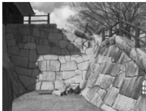
▲石垣や屋根瓦が破損した御城展望台（山方）
