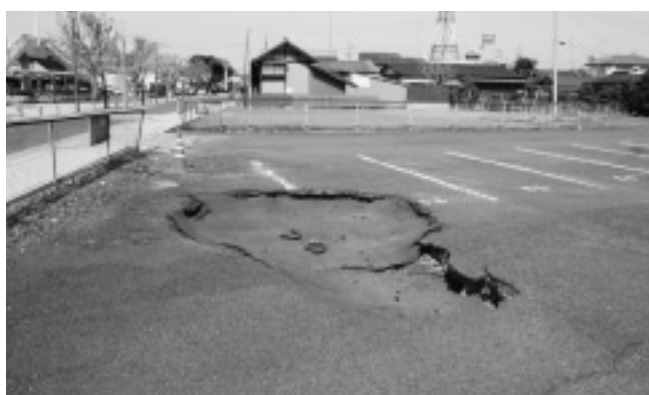
駐車場の一部が陥没
