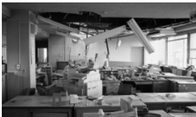
望楼が倒壊し、消防本部の事務所を直撃
