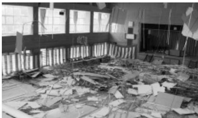
御前山小学校体育館の天井も崩落
