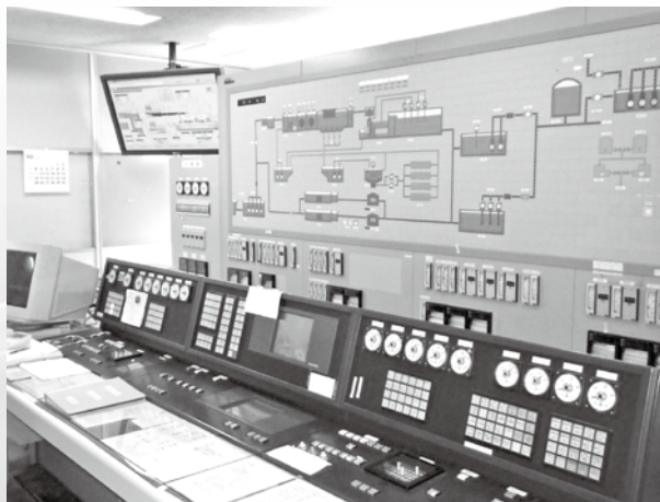
▲水道管理事務所内にある遠隔監視装置
