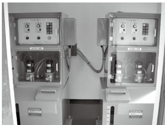
▲塩素注入装置
