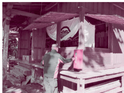
▲神社で消火器の点検
