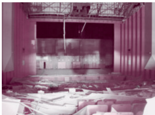
▲天井が崩落した文化センター大ホール
