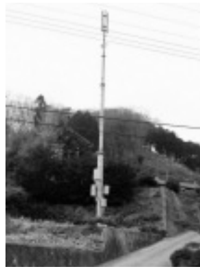
▲千田地区に建設された鉄塔
