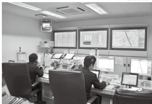
▲消防本部通信指令室
