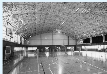
老朽化が進む山方中学校体育館
