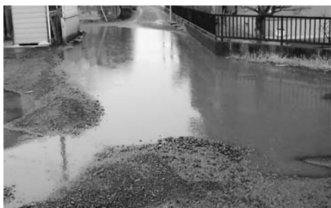
側溝がないため排水できない
