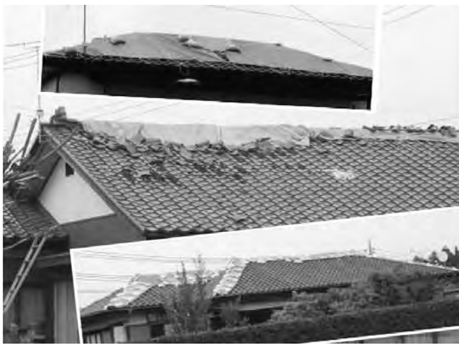
被災した屋根
