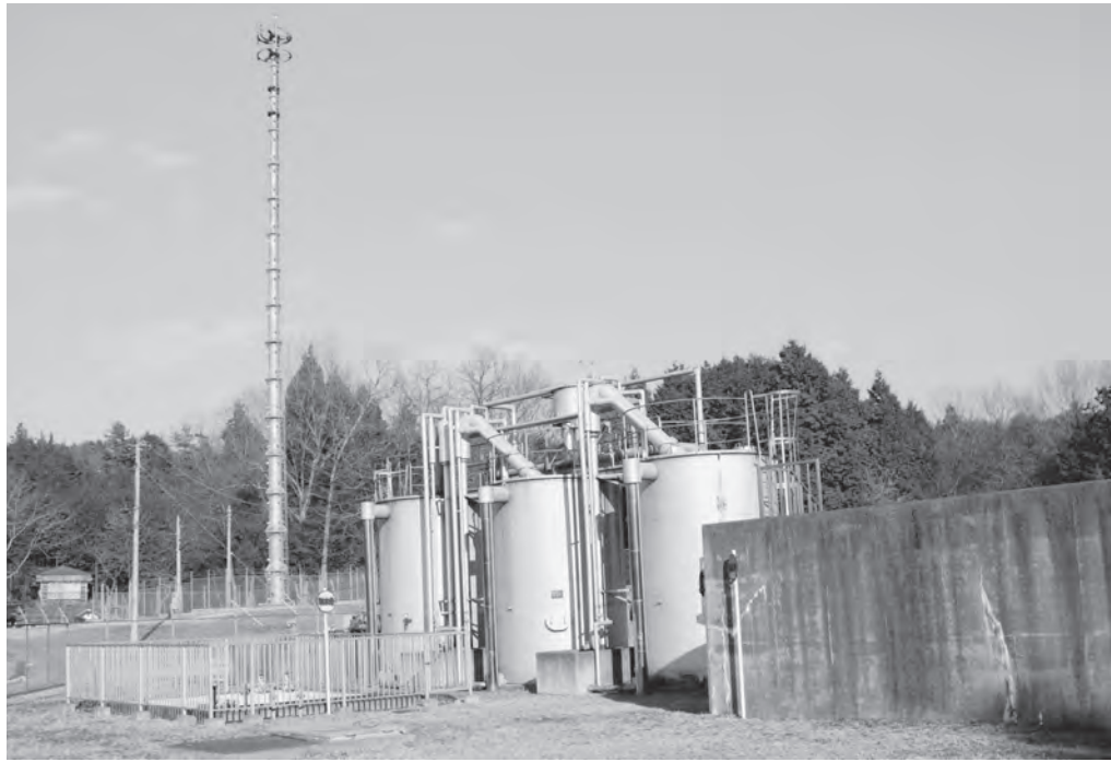
簡易水道の機場
