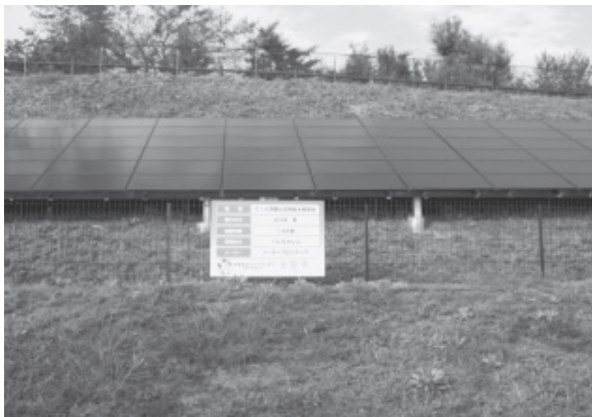
太田市北部運動公園内に設置されている太陽電池モジュール
