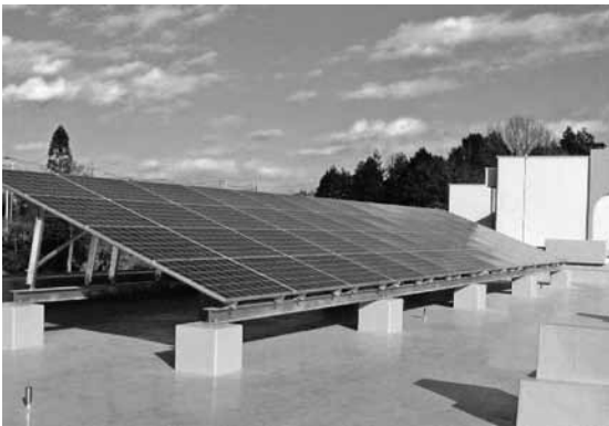
大宮西小屋上に設置された太陽光パネル
