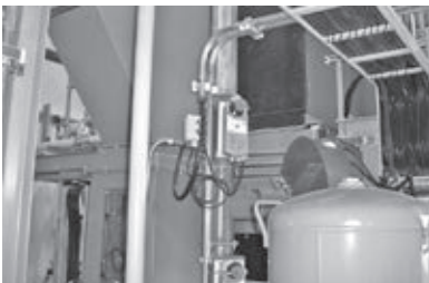
ささの湯に設置したバイオマスチップボイラー
