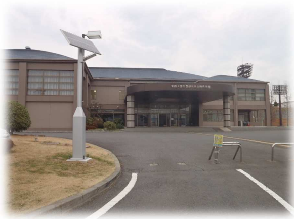
太陽光発電システム付きLED街灯
