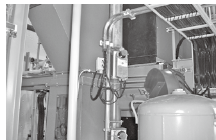
ささの湯に設置した バイオマスチップボイラー
