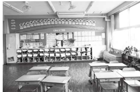
各学校の普通教室に設置されたエアコン
