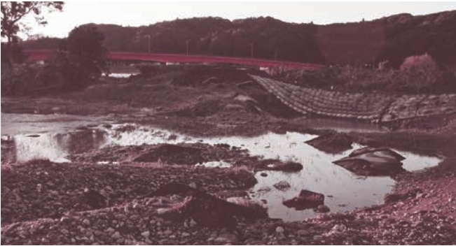
▲下伊勢畑地内の破堤の様子
