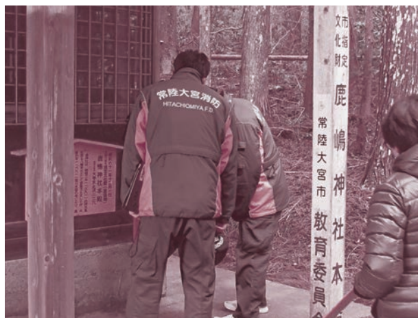
▲文化財防火設備点検（水之沢鹿嶋神社）
