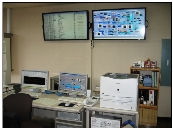
遠隔監視システム
