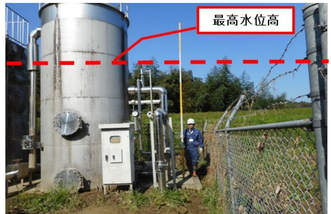
御前山地域上伊勢畑取水・浄水場被災状況
