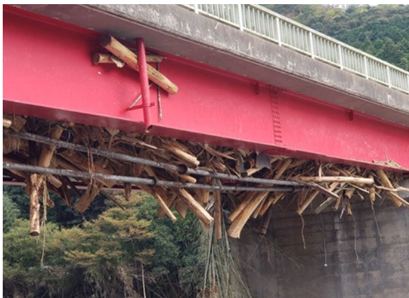
山方地域下小川橋被災状況
