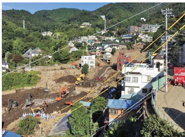
▲土石流災害の現場
