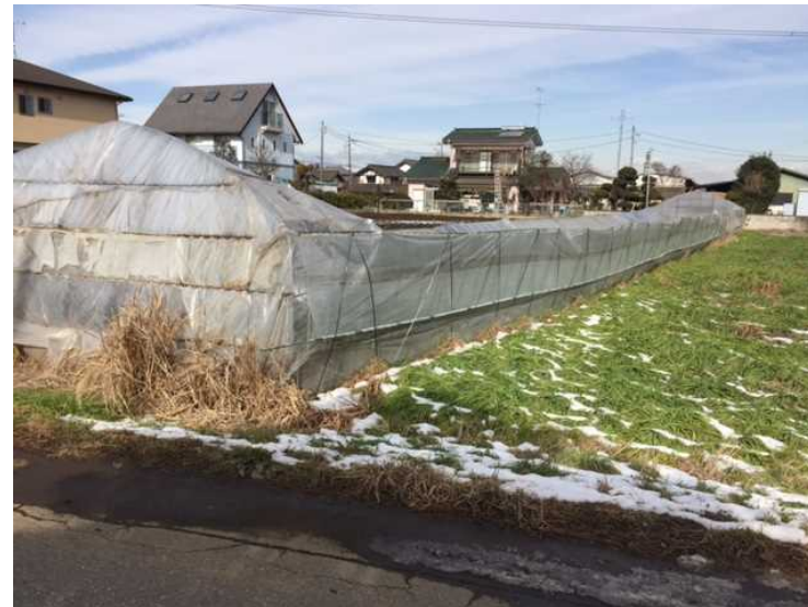
大雪でのハウスの倒壊②
