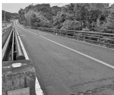
整備が必要な中玉川橋
