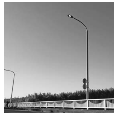
LED化された辰ノ口橋の照明灯
