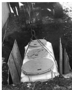
交換された合併浄化槽
