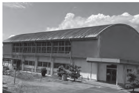
さび劣化が進む旧大場小学校体育館の屋根
