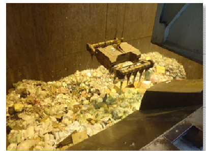
大宮地方環境整備組合 環境センター 可燃ごみピット
