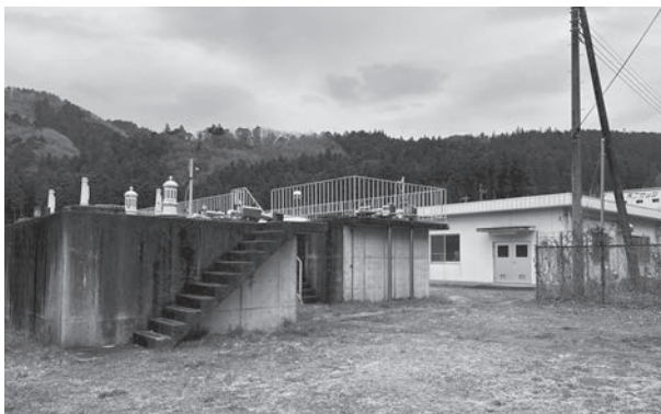
低水位の状態が発生した美和浄水場
